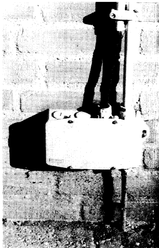
De afwerking op de begane grond, de aardelektrode verdwijnt hier de grond in.
